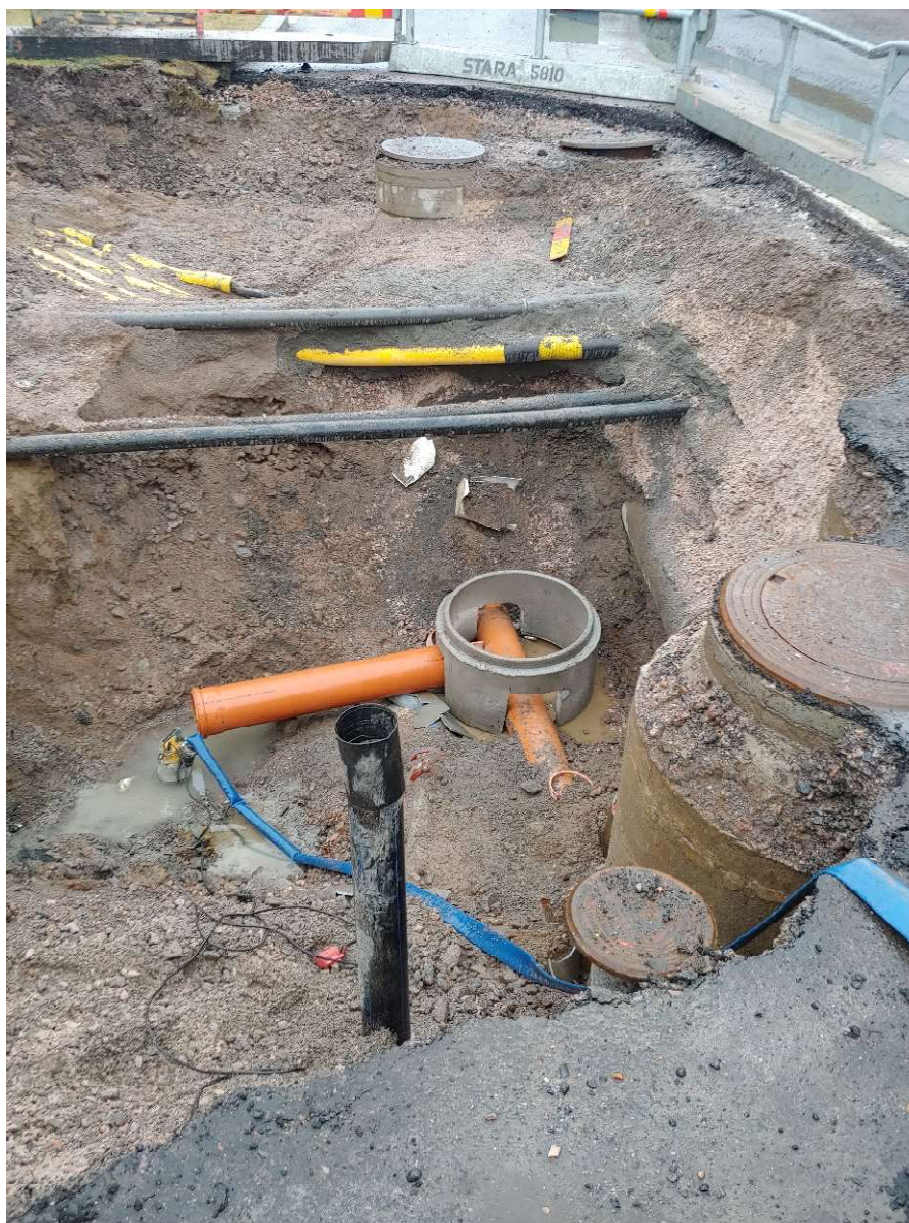
Kuva 12. Muovisen jätevesi viemärin satulakaivon rakentaminen Jäkälätien ja Jäkäläpolun risteyksessä vuonna 2020. Kuvan ottanut Bo Telén.
