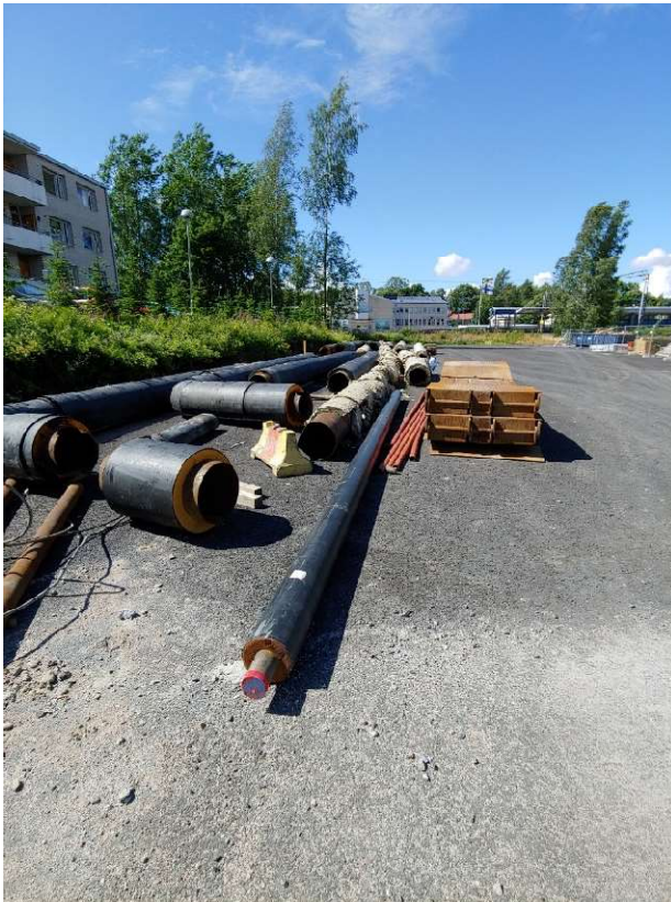
Kuva 13. Kuvassa uudempiä ja vanhoja kaukolämpöputkia. Kuva otettu Sammaltorin LP-alueelta vuonna 2020. Kuvan on ottanut Bo Telén.
