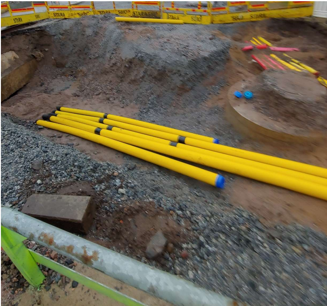
Kuva 14. HSV:n putkia Jäkälätien ja Jäkäläpolun kulmassa vuonna 2020. Kuvan ottanut Bo Telén.
