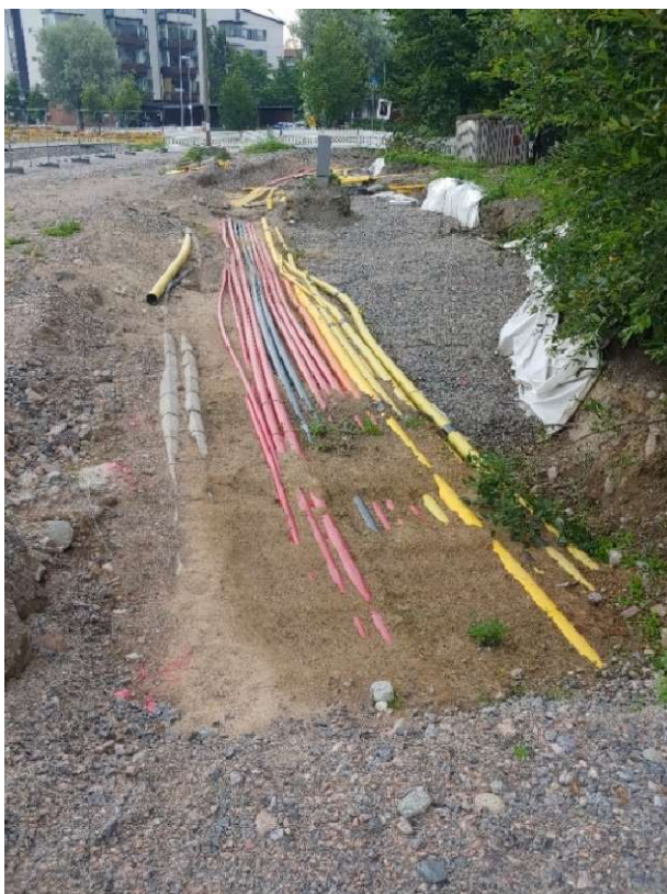
Kuva 9. Kaapelinsuojaputkia ja vanhempi betonikouru suojaus Jäkälätien varressa vuonna 2020. Kuvan ottanut Bo Telén.
